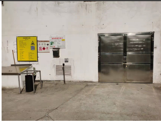
图 2-17 二厂 3-2#危废库门口标识情况
