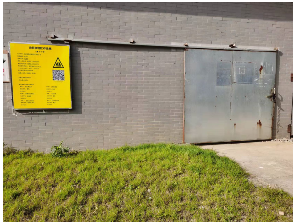
图 2-15 二厂 3-1#危废库门口标识情况
